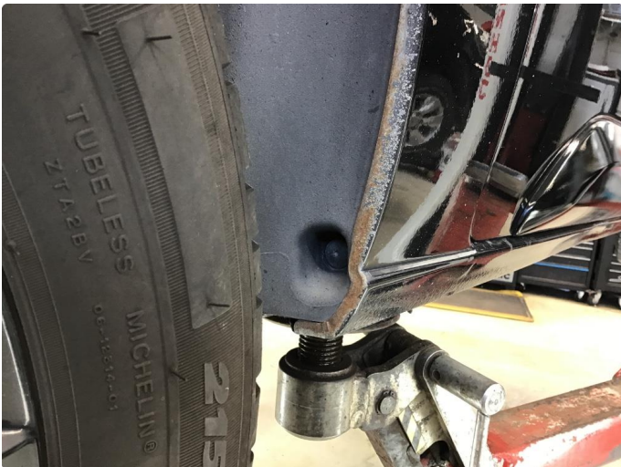
1.1 Steinsprut med rust
