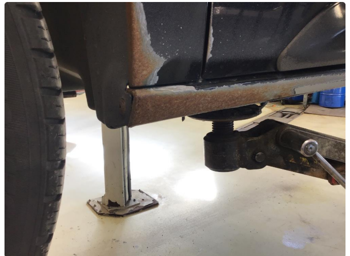
1.1 Steinsprut med rust
