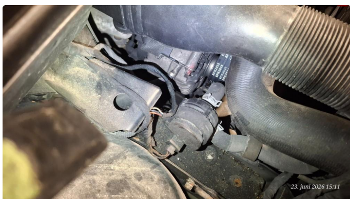
4.2 Lekkasje fra oljekjøler
