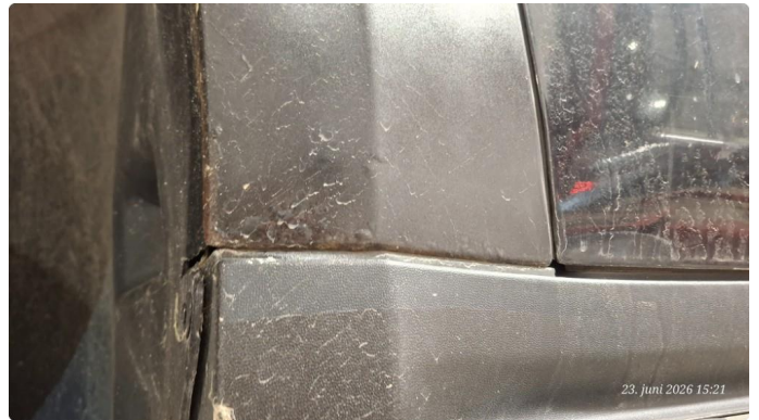
2.1 Ufagmessig utført arbeid
