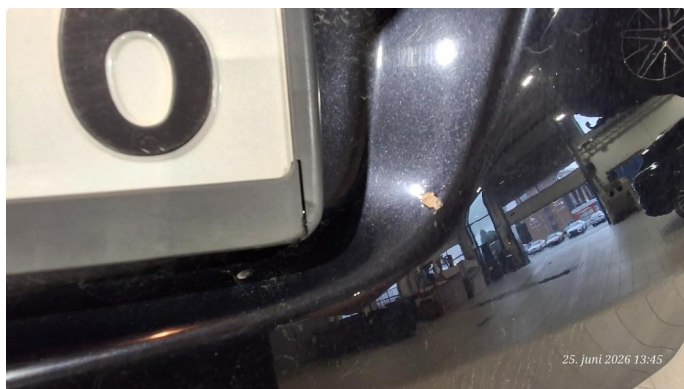
1.2 Generelt mye rust
