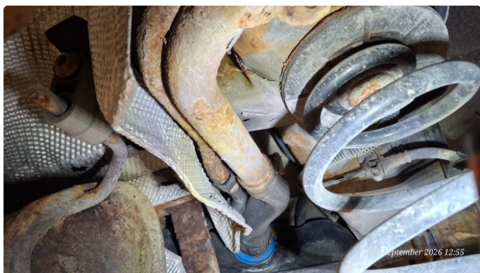
5.1 Rust på drivstoffrør
