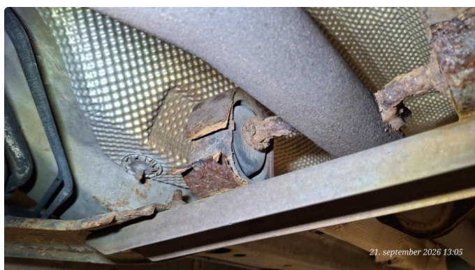
5.3 Eksosrør innfestning defekt/mangler
