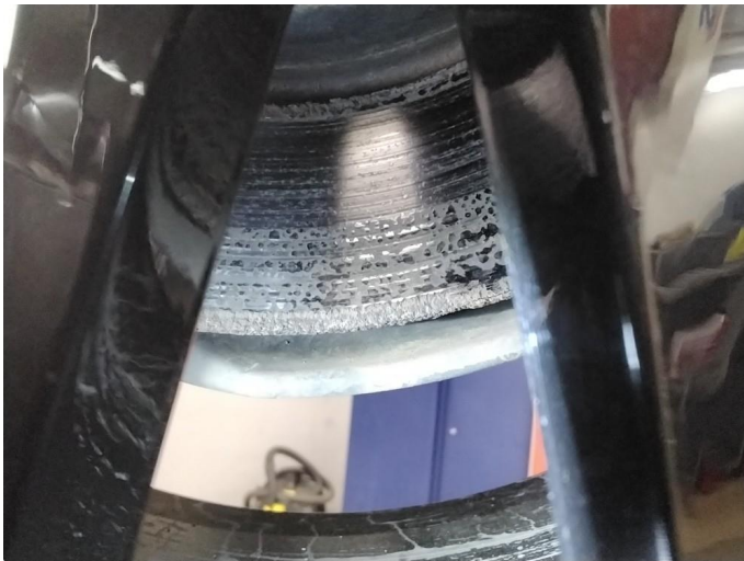
2.1 Mer enn 25% rust.
