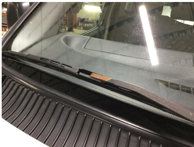
1.1 Flekkvis noe korrosjon/rust
