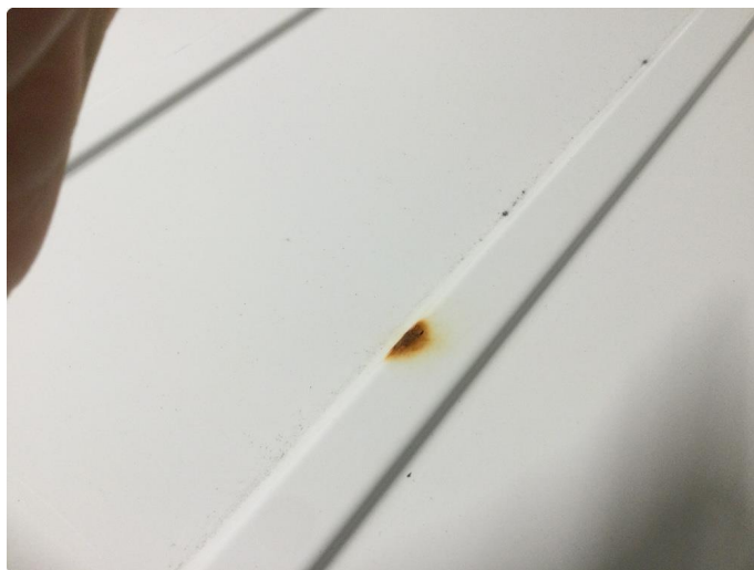
1.1 Flekkvis noe korrosjon/rust
