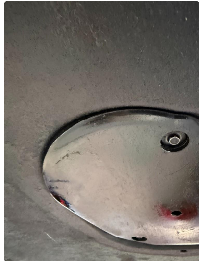
2.1 Oljelekkasje fra motor
