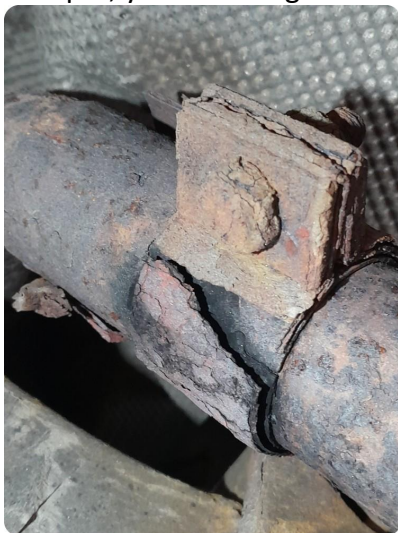
4.1 Eksoslekkasje Defekt eksosklemme på bakre lydpotte
