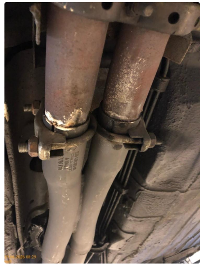
3.1 Liten eksoslekkasje midtre del under bil.
