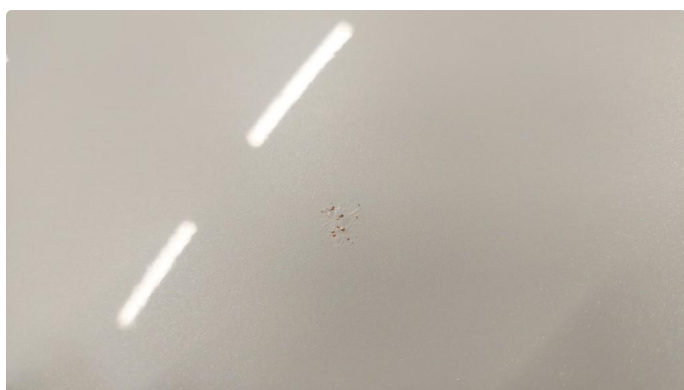
1.3 Steinsprut med rust
