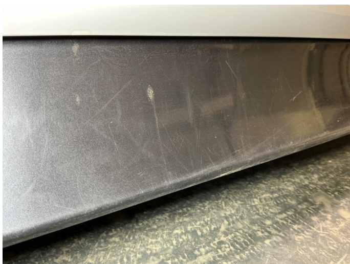
1.5 Kanaldekler begge sider - riper og mekanisk slitasje
