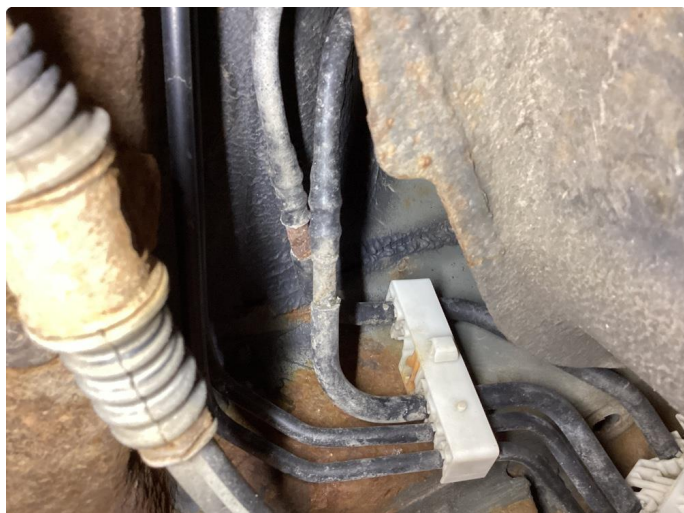
4.1 Rust på drivstoffrør
