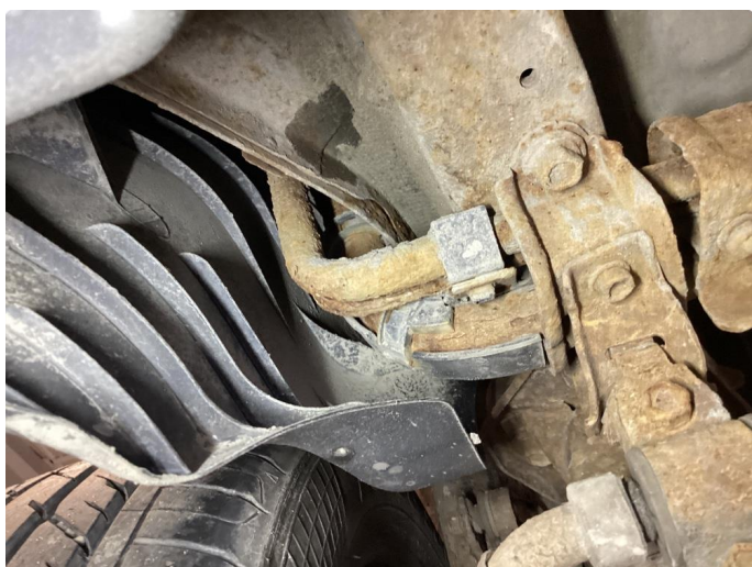
3.1 Rust på drivstoffrør
