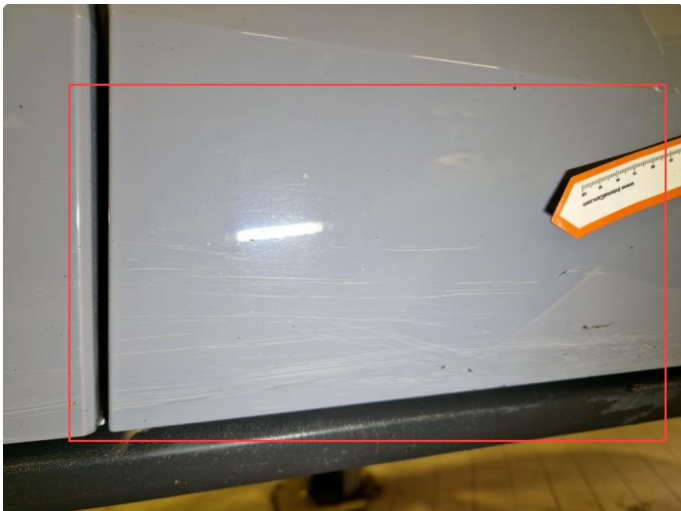
1.1 1 Stk liten p-bulk + noe bruksmerker nedre del h-framdør, normal bruksslitasje.
