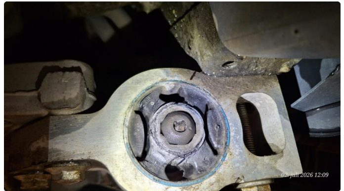
2.1 Noe slitasje bærebreforing
