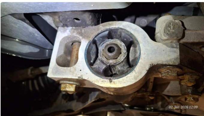
2.1 Noe slitasje bærebreforing
