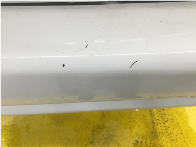
1.1 Ripe(r) ned til grunning
