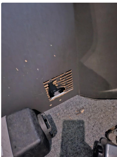
2.1 Skadet/merker etter utstyr
