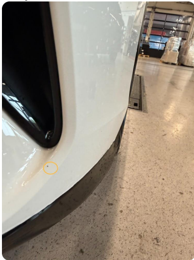
1.2 Steinsprut Normal slitasje - flekke
