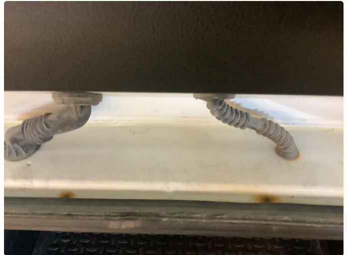
1.3 Øvrige feil, Litt rust i overkant av åpning.
