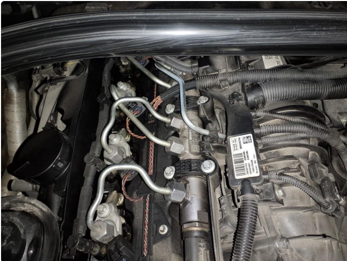
2.1 Lekkasje på drivstoffanlegg, våt rundt dyser.
