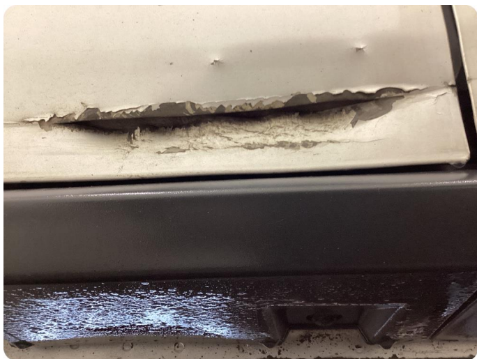
1.3 Skade Skyvedør hs har revnet.
