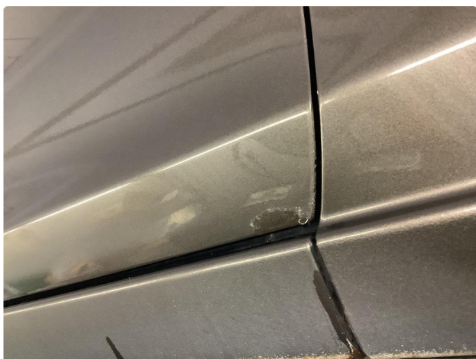
1.2 Generelt mye rust
