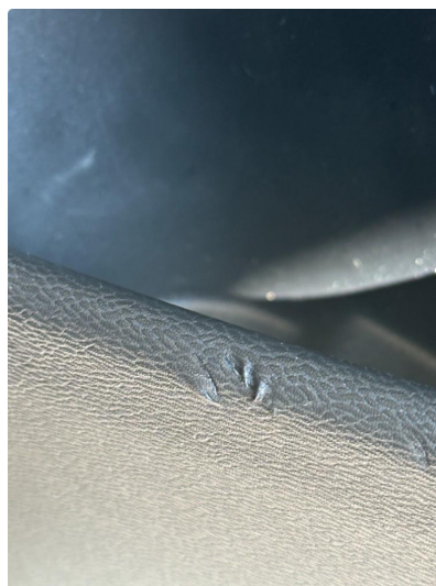
2.1 Noen merker i dørtrekk høyre bak
