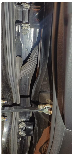
1.1 Ufagmessig utført arbeid
