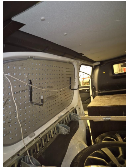
3.1 Bruksslitasje i varerom
