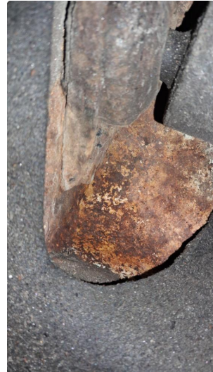
2.1 Rust på innfestning til støtdempere bak.
