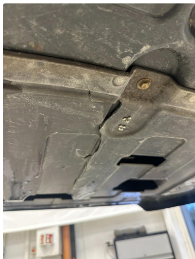
1.1 Noen sprekker i beskyttelsesplate under bilen
